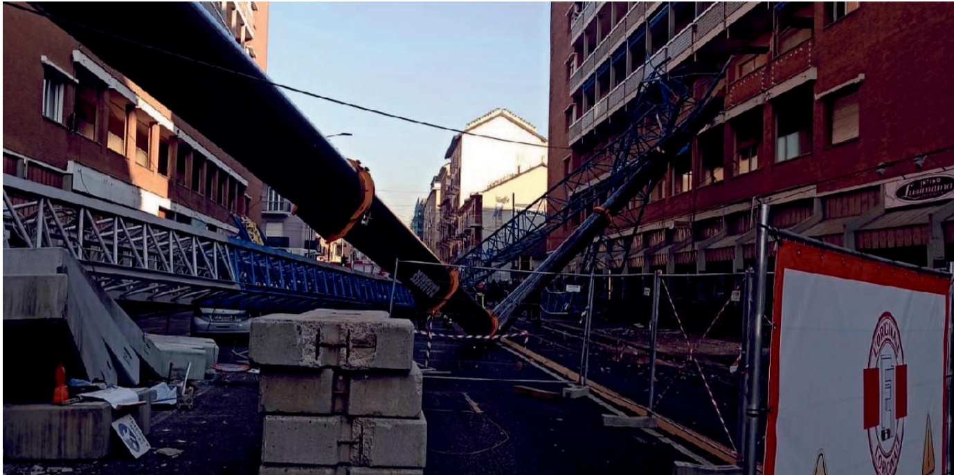
Via Genova a Torino il giorno dopo: è stata posta sotto sequestro l'area dell'incidente in cui hanno perso la vita i tre operai specializzati
